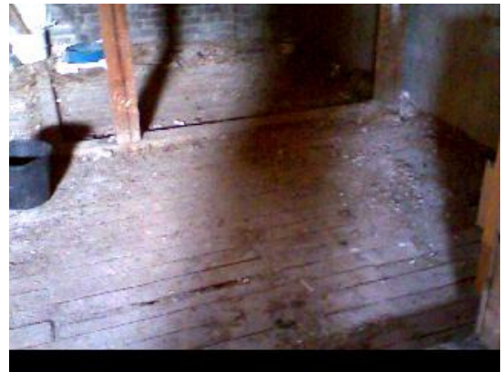
Soojalekked katuse pööningul.
