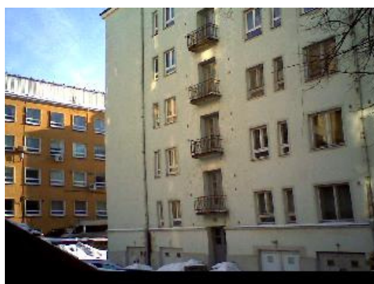
Hoone välissein Kütteradiaatorid paistvad läbi, mis viitab seina viletsa soojapidavusele
